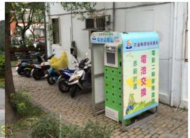
增設電池交換站
