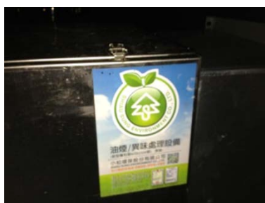
餐飲業者裝設過濾油煙處理機
