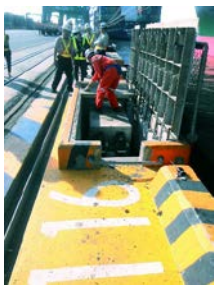
推廣港區高壓岸電設置
