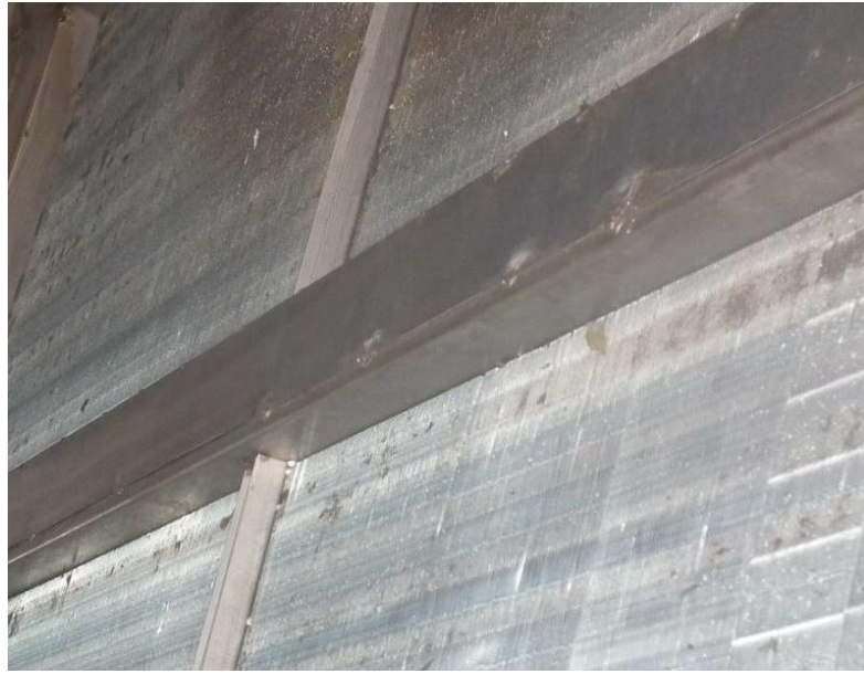
圖 17 空調系統冷卻盤管髒污情形
