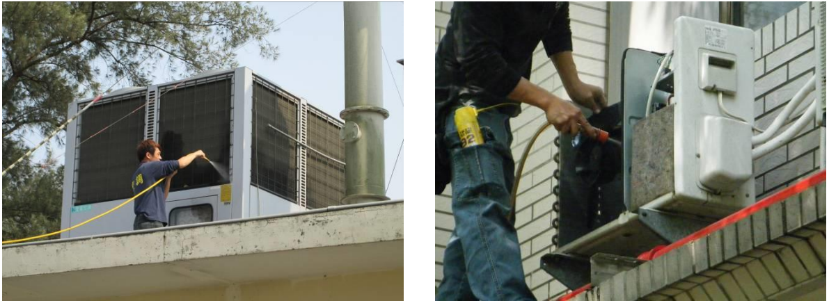
圖 31 氣冷式冰水機及散熱鰭片維護與清潔
