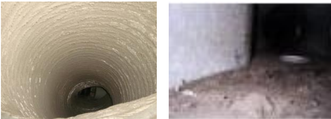
圖 41 空調風管積塵之情形
