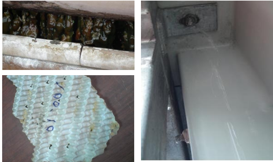
圖 26 冷卻水塔附著髒污及漏水情形
