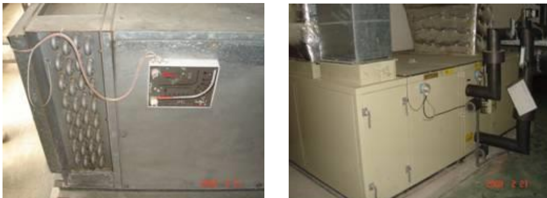
圖 38 過濾網壓差感知裝置的檢修與維護
