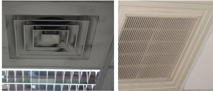
圖 16 中央空調箱或送風盤管系統空調出風口及空調回風口
