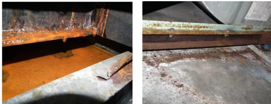
圖 18 空調系統冷卻盤管髒污情形
