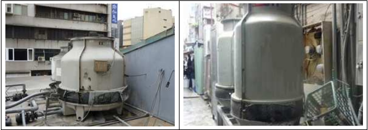
圖 12 冷卻水塔設備實景圖
