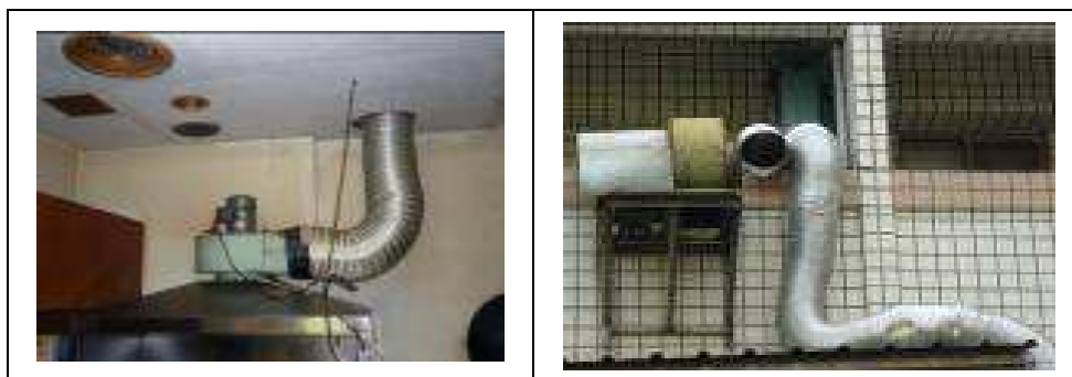
圖 14 常見廚房抽油煙機及管線
