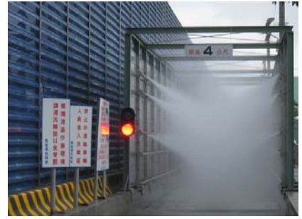
自動洗車設備(設置紅綠燈管制車輛清洗時間)
