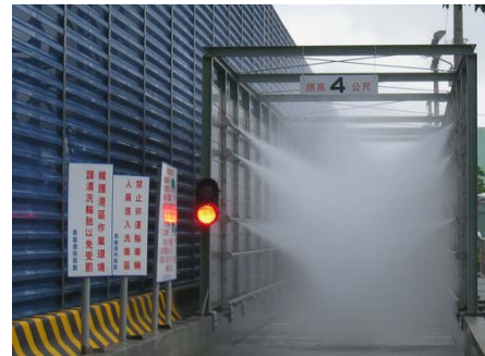
自動洗車設備(設置紅綠燈管制)
