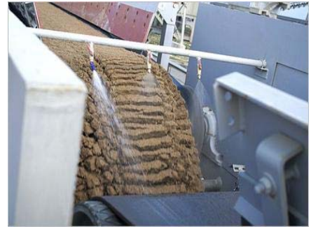
於接駁點設置自動灑水設施
