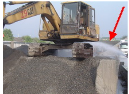
配置灑水設備
