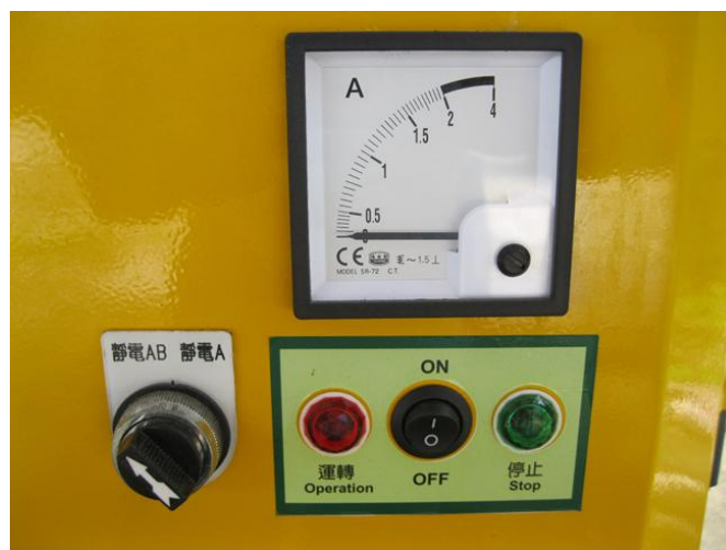
圖 3-9、靜電集塵器之設備使用電流儀錶
